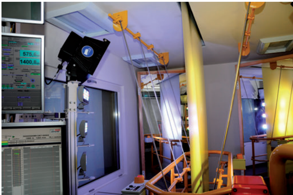
La cabina di ispezione della linea di preverniciatura di Eisenhüttenstadt garantisce una qualità superficiale in linea con gli standard europei per gli elettrodomestici.
