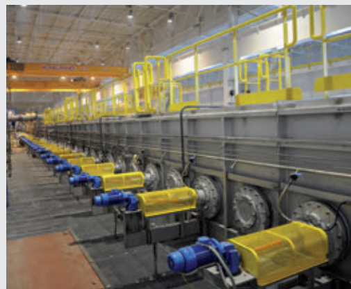
Vista del nuovo forno di St. Chély d'Apcher
