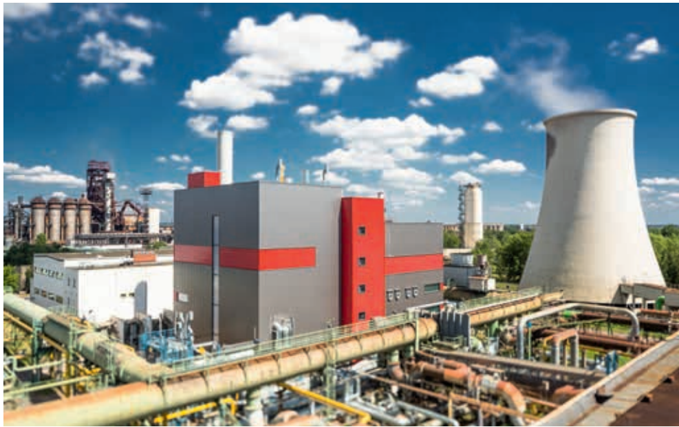
W zakładach ArcelorMittal w Eisenhüttenstadt gazy odlotowe płyną (od lewej do prawej) rurami na zewnątrz zakładu, bezpośrednio do kotłów elektrycznych.
