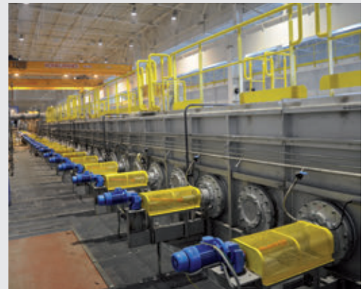
Vedere a noului cuptor de la St. Chély d'Apcher
