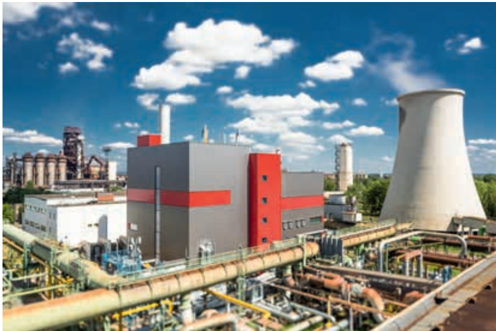
Gazele de evacuare pe fluxul de la combinatul ArcelorMittal Eisenhüttenstadt (de la stânga la dreapta) prin conductele de culoare verde, direct în boilerile centralei termice exterioare.
