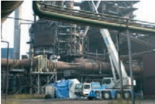
La tecnología TRT se ha instalado en seis hornos altos de FCE. Se han identificado otros ocho adecuados para su conversión.
