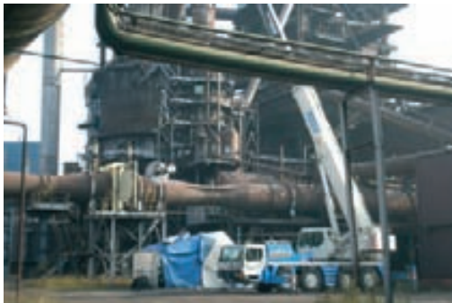
Er is al TRT-technologie geïnstalleerd in zes van de FCE hoogovens. Nog eens acht hoogovens in Europa zijn geschikt bevonden voor ombouw.
